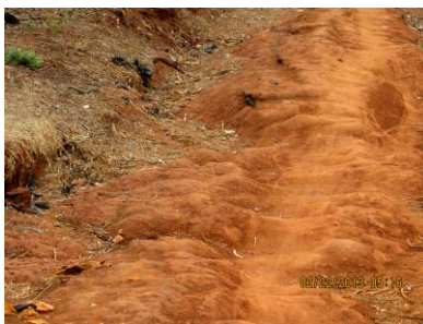
Photo 2 : rue dégradée en surface à Togadji
