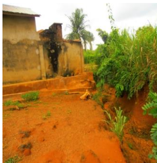
photo 4 : Rigole mise en place par l'érosion pluviale à Houin
