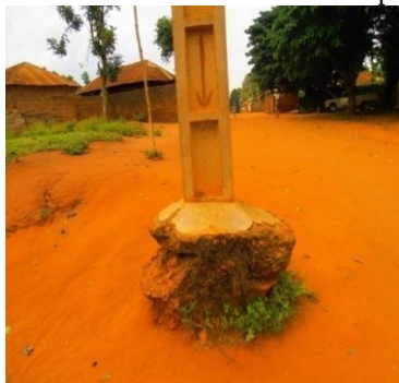
Photo 3 : un poteau électrique déchaussé à Covè centre
