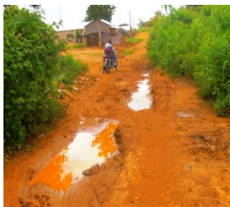
Photo 1 : rue dégradée en surface et aux abords à Houin Prise de vue : Vissin, Juin 2015
